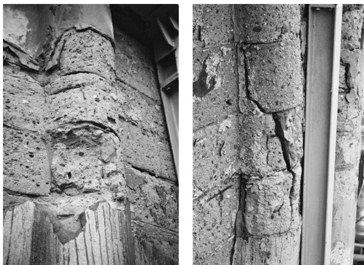
Rys. 9. Uszkodzenia uźebrowania prefabrykowanej powłoki walcowej
