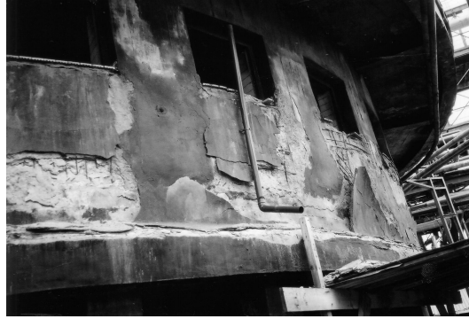
Rys. 3. Uszkodzona dolna monolityczna część powłoki wieży
