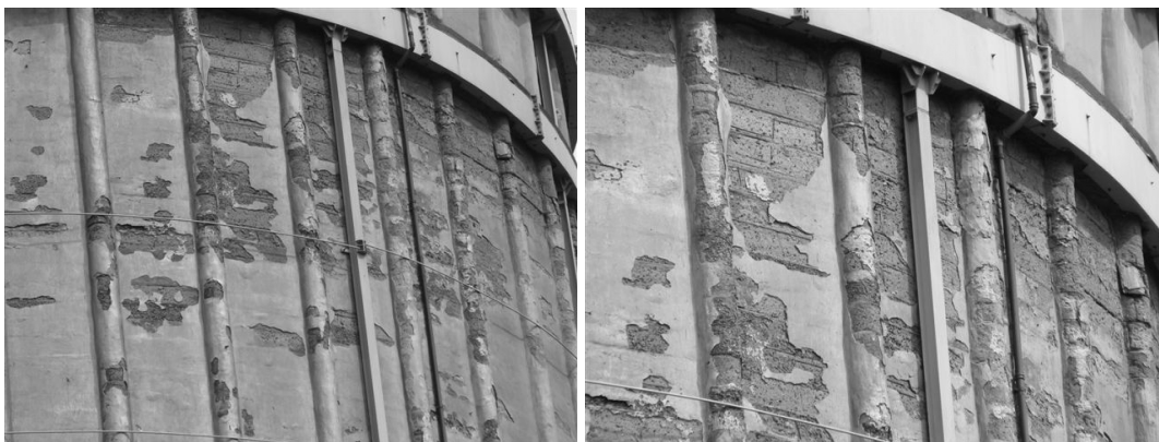
Rys. 8. Dobry stan stalowej konstrukcji wzmacniającej, uszkodzenia korozyjne elementów żelbetowych
