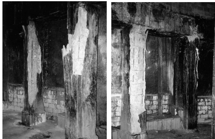
Rys. 4. Rozległe uszkodzenia słupów podbudowy
