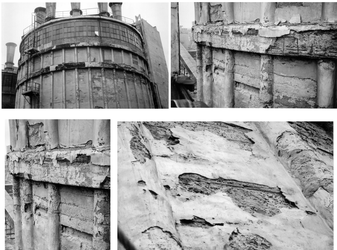
Rys. 2. Charakterystyczne uszkodzenia korozyjne prefabrykowanej części wieży granulacyjnej
